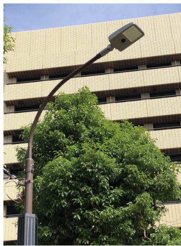
照明・バッテリーユニット
